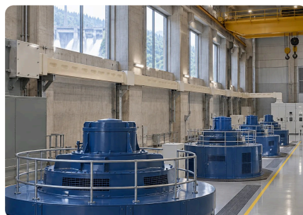
Centrales de generación
